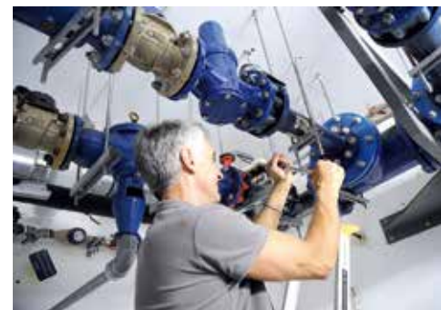
Les fuites d'eau sont sous haute surveillance.
