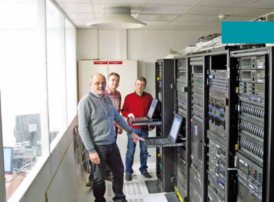
Une des salles de serveurs informatiques à l'Hôpital Nord.
