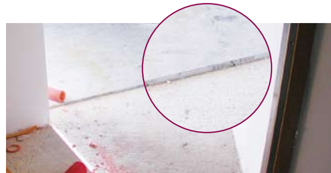
Les chambres de l'ICL ont une chappe en béton recouverte de 2 cm de plomb.
